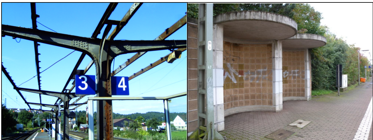
Abb. IV-11: Beispiele für fehlende Bahnsteigüberdachungen in Edermünde-Grifte (links) und unzureichende Wetterschutzbauten in Vellmar-Niedervellmar (rechts)
